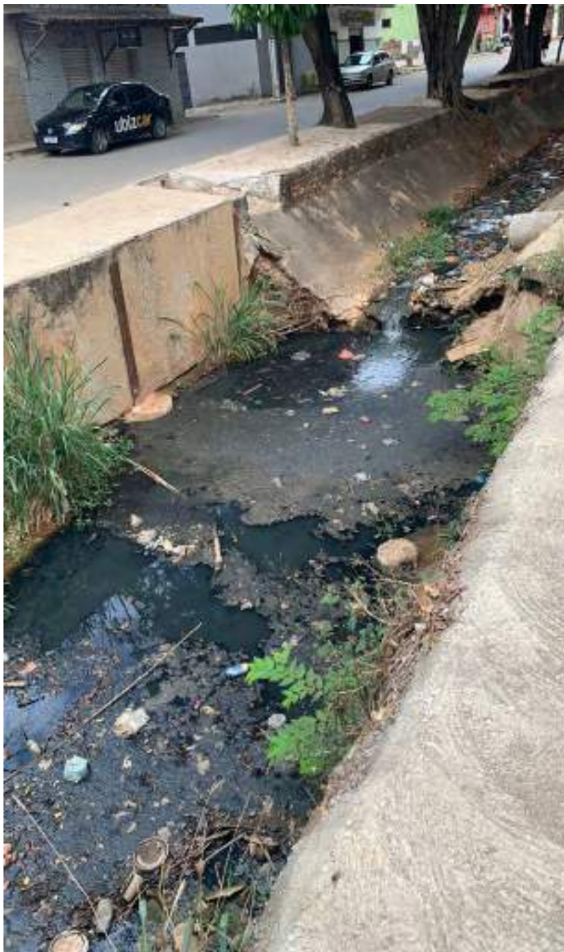
Figura 5 – Condições da infraestrutura do bairro Turmalina
